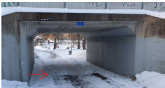
Exempel där snöröjare inte tycks ha kunnat komma in i 3 m hög tunnel i Nyköping.
